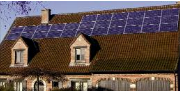
▲ Opbouw, Steenokkerzeel, 5,88 kWp, 2009
